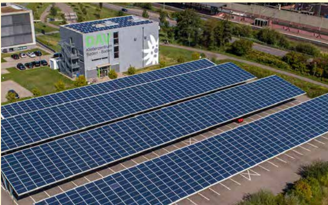
Park&Ride-Parkplatz der Stadtwerke Baden-Baden mit 371,3 kWp Photovoltaik
